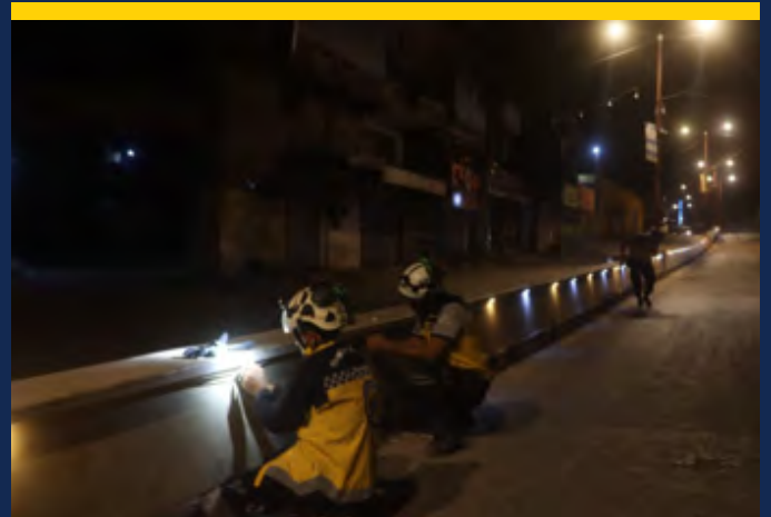
تركيب إنارة شوارع بطول 600 متر في وسط الطريق الرئيسي في مدينة أريحا في ريف إدلب الجنوبي.
